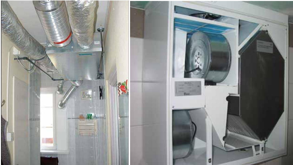
Obr.19: Efektivní větrání prostor lze zabezpečit i decentrálními jednotkami. Umístění jednotky (vlevo) je zde řešeno jednoduchým způsobem do podhledu v prostoru chodby s malými nároky na prostor, s minimálním počtem a délkou rozvodů. Vpravo umístění jednotky v koupelně.
