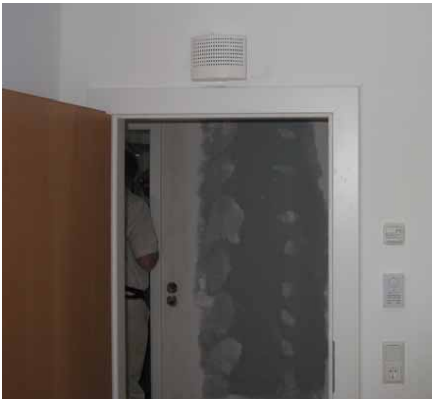
Obr 17: Viditelné jsou jen vyústky nad dveřmi přivádějící vzduch. (Zdroj CPD)
