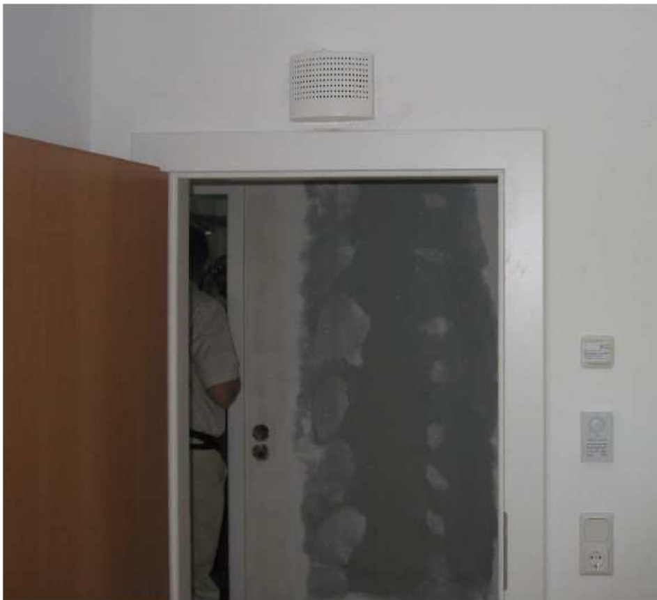
Abbildung 16: Nur der Luftauslass über der Tür ist sichtbar (Quelle: CPD)
