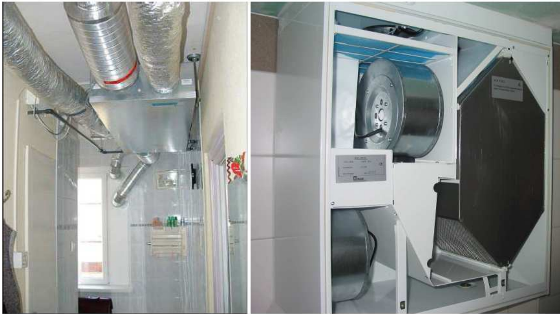
Abbildung 18: Eine wirksame Lüftung kann durch dezentrale Lüftungsgeräte bereitgestellt werden. Es ist eine großartige Lösung mit wenig Platzbedarf und einem Minimum an Lüftungsleitungen. Die Aufstellung verfolgt unter abgehängten Decken im Flurbereich (links) oder im Bad (rechts). (Quelle: Solanova Consortium, CPD)
